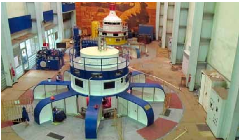
ГЭС-10. Машинный зал ТГК-1 Выполнен монтаж электротехнических устройств систем автоматизации и РЗА Г-1
