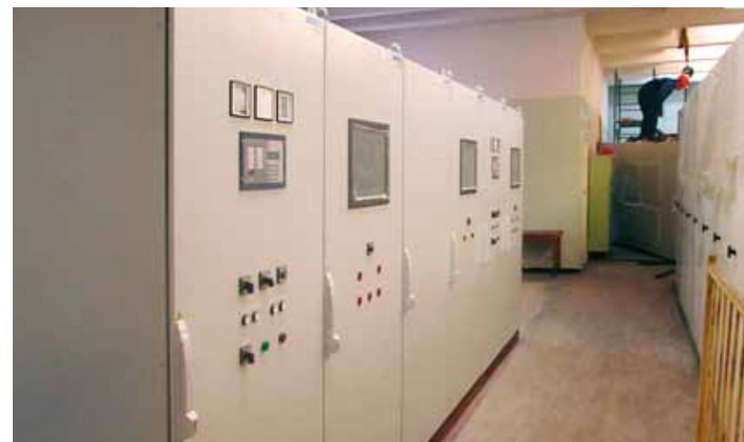
ГЭС-10. Машинный зал ТГК-1 Шкафы систем автоматизации (АСУ) и РЗА Г-1
