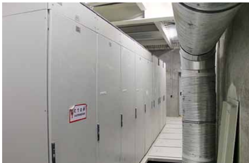
ГОК «Олений ручей» Силовые шкафы управления (ЩСУ) электроприводами. Корпус обогащения
