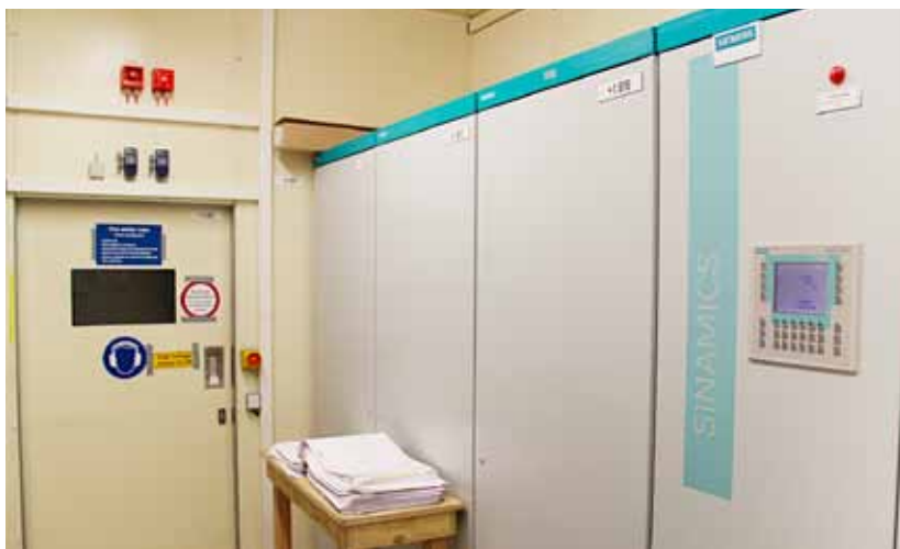
ОАО «Кольская ГМК». Комбинат «Печенганикель» ОФ-1. Шкафы управления электроприводами шаровых мельниц (9,5МВт)
