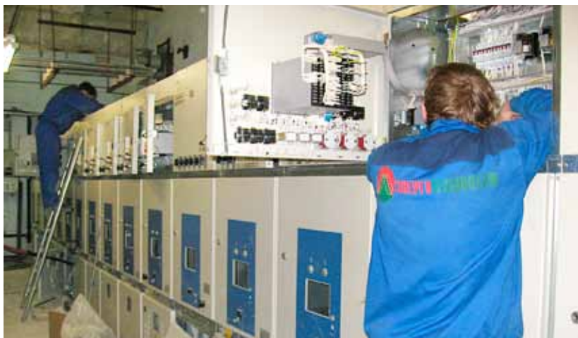
ОАО «Кольская ГМК». Рудник «Северный-Глубокий» ЦВС. Электрооборудование РУ-6кВ ГПП 35/6кВ
