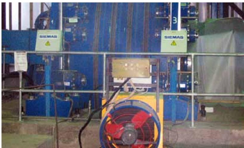
ОАО «Кольская ГМК». Рудник «Северный-Глубокий» Электропривод скиповой подъемной машины (4,6МВт)
