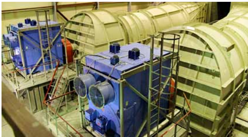
ОАО «Кольская ГМК». Комбинат «Печенганикель» Рудник «Северный-Глубокий» Электроприводы вентиляторной главной проветривания (мощность электродвигателей 4,5МВт). ГВУ-5
